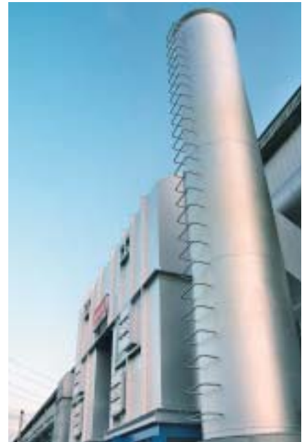
蓄熱式脱臭処理装置
