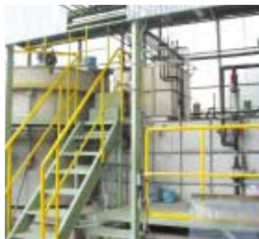
塗装排水処理システム
